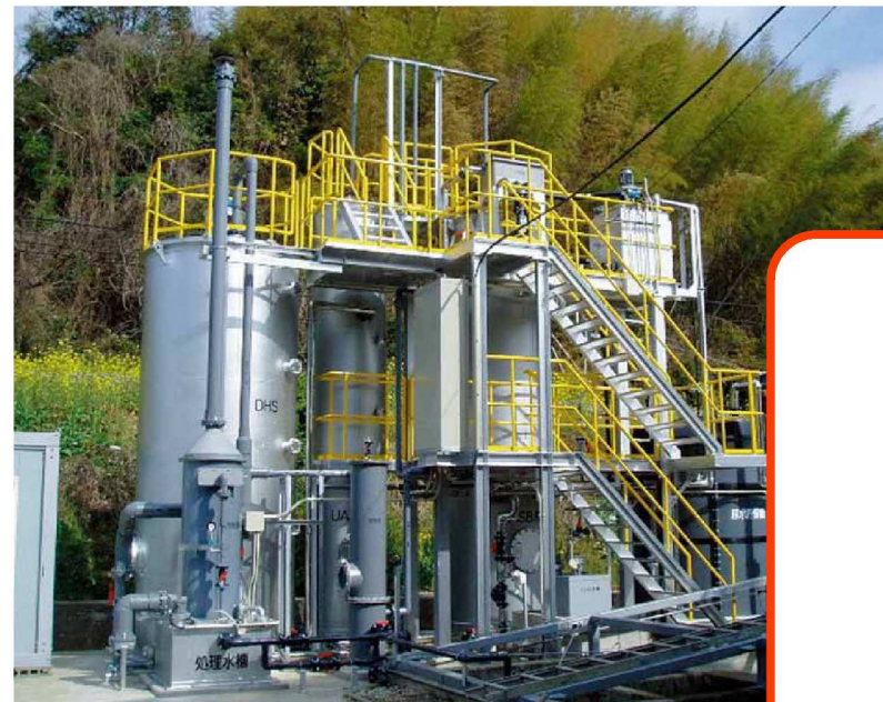
有機性廃水処理プラント
